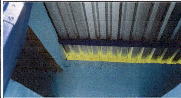
FOTO 1: Sustitución de lámina, por lámina troquelada aluzinc calibre 26 Y Sustitución de estructura de soporte de madera, por metal
